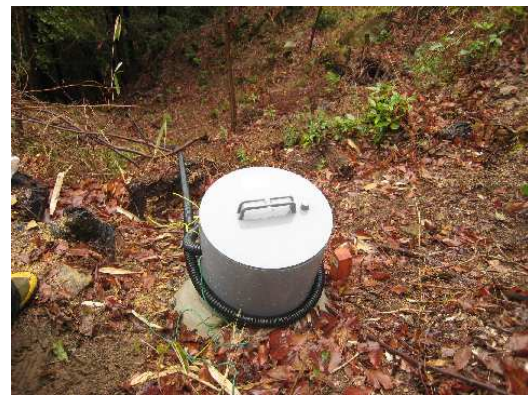
図-6 水位計設置マスと電線管の外観
