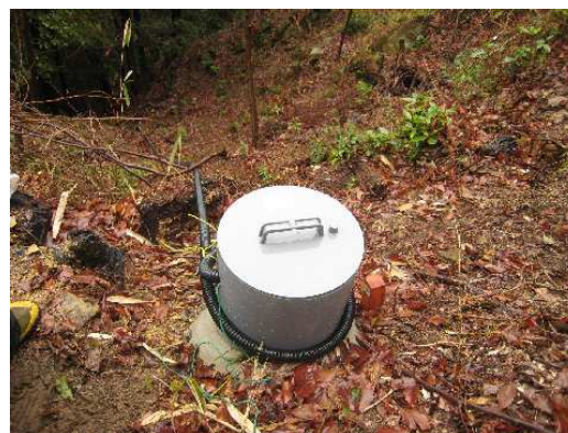
図-6 水位計設置マスと電線管の外観
