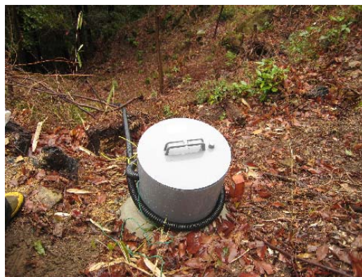
図-4 水位計設置マスと電線管の外観
